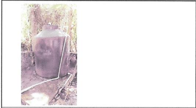
Foto 7: Mantenimiento de la cisterna del agua ya que le hacven falta sus accesorios para que funcione perfectamente
