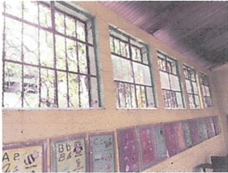
Foto 3: Reemplazo de vidrios ya que hay faltantes
