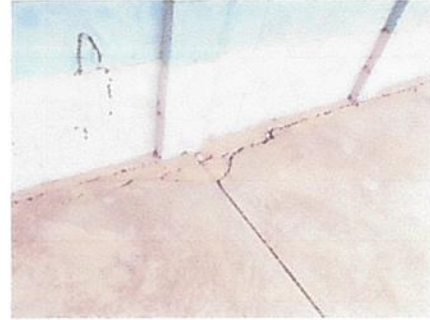
Foto 4: Cambio de piso ya que se encuentra rajado
